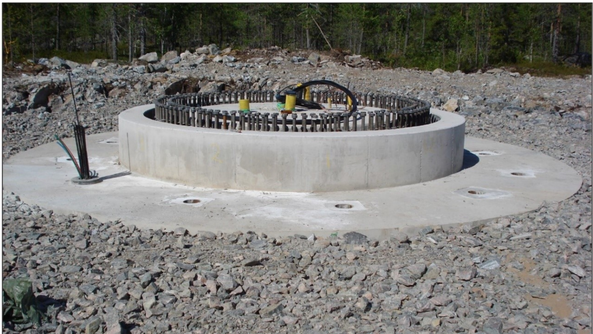
Kuva 25. YIT Suomi Oy:n toteuttama tuulivoimalan kallioankkuroitu teräsbetoniperustus (kuvan lähde: YIT Suomi Oy).
